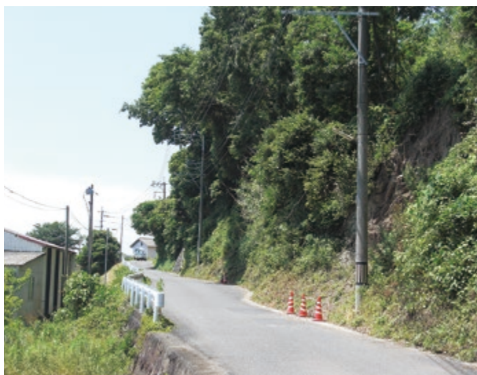
のり面对策が必要な町道合串福浦線
