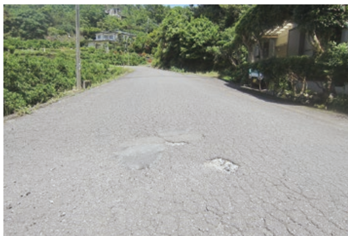
町道の路面損傷状況
